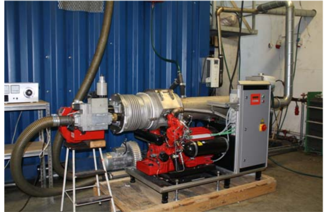
Kuva 8. Stirling-moottori asennettuna puukaasu käyttöön.
