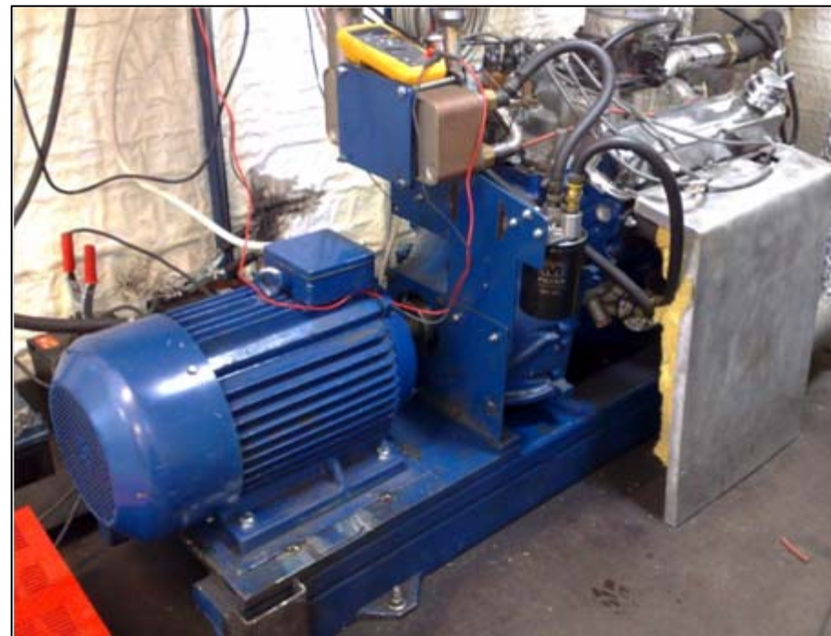
Kuva 2. 3-vaihe oikosulkumoottori asennettuna sähköntuotantoon.
