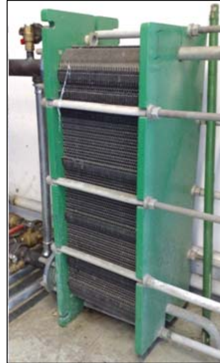
Kuva 5. Levylämmönvaihdin, jolla syntyvä lämpö siirretään kiinteistön lämmitysverkkoon.
