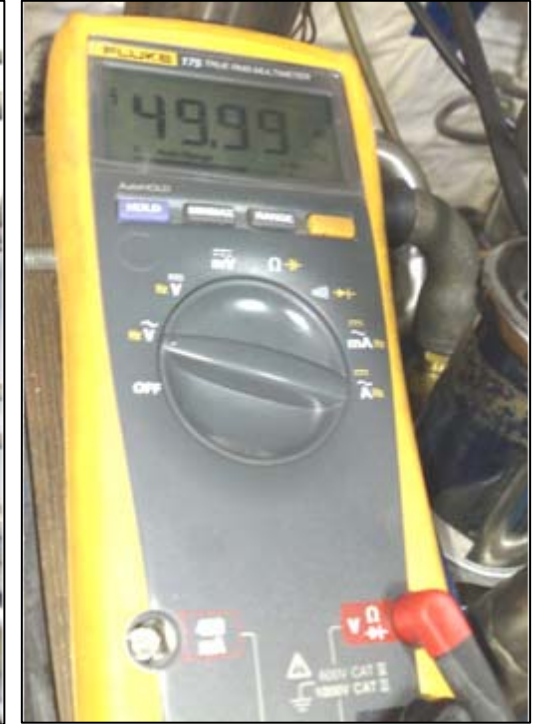
Kuva 6. Generaattorin manuaalinen tahdistaminen yleismittarilla ennen kytkemistä verkkoon (49,99 Hz).
