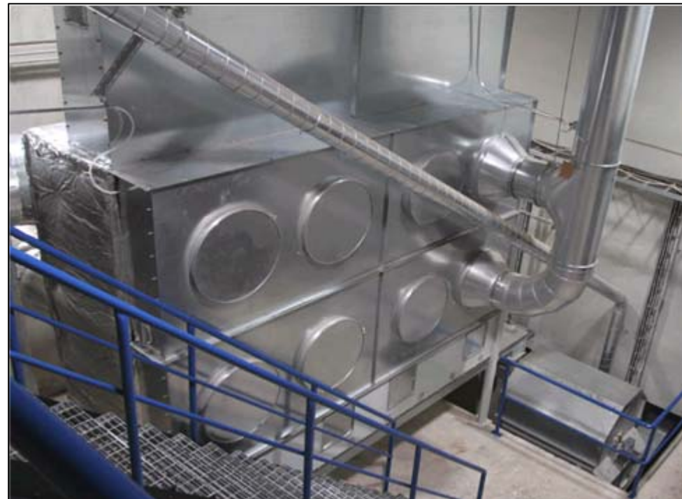
Kuva jatkuvatoimisesta siilokuivaimesta. Kuivain sijaitsee CHP- laitoksessa Lestijärvellä, Keski-Pohjanmaalla.
